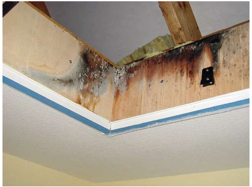
▶ Auch an der Dachluke hat sich Kondensat niedergelassen und als Folge Schimmel gebildet
