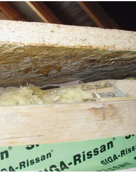
◀ Die Bodenplatten im unausgebauten Dachboden sind von Schimmel befallen
